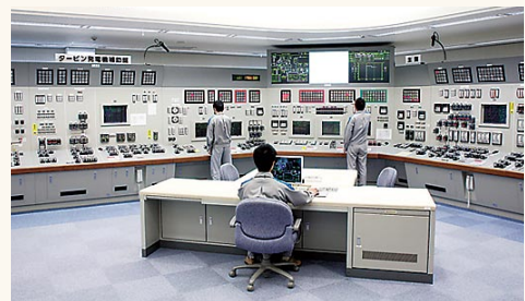
玄海原子力発電所訓練センターシミュレーター室
