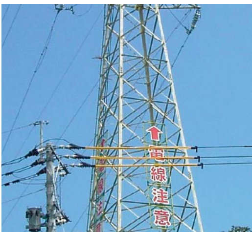
注意喚起標識の設置状況
