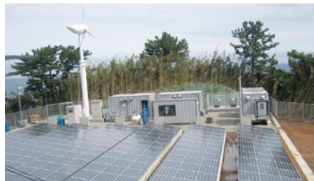
黒島の実証試験設備(鹿児島県)
