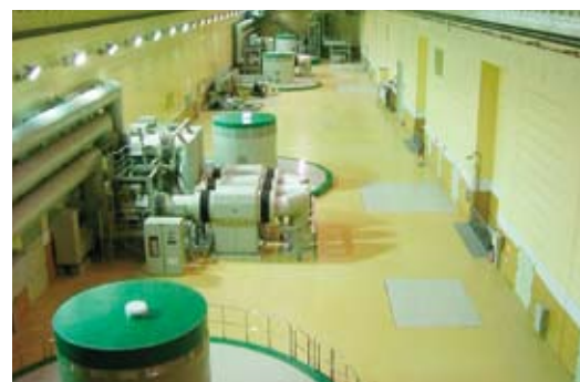
小丸川発電所(地下発電所)
