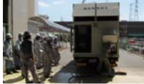
高圧発電機車の繋ぎ込み
