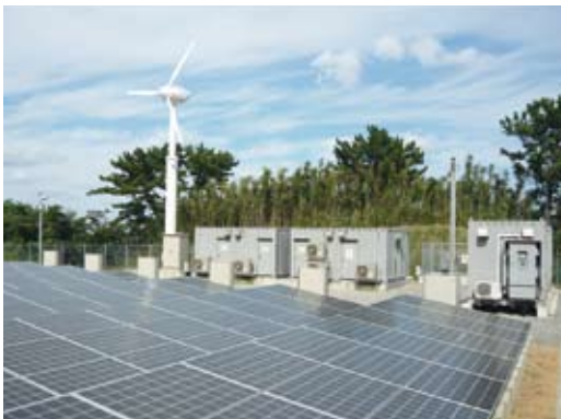
黒島の実証試験設備(鹿児島県)
