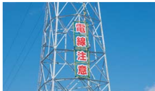
注意喚起標識の設置状況
