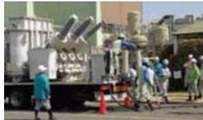
車載型移動用変圧器の接続
