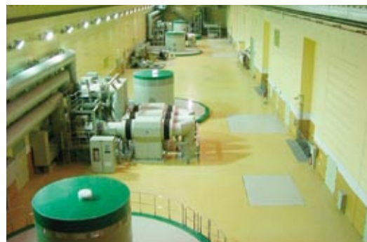
小丸川発電所(地下発電所)
