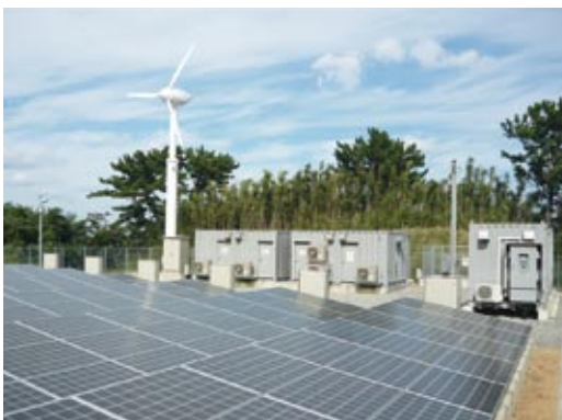
黒島の実証試験設備（鹿児島県）
