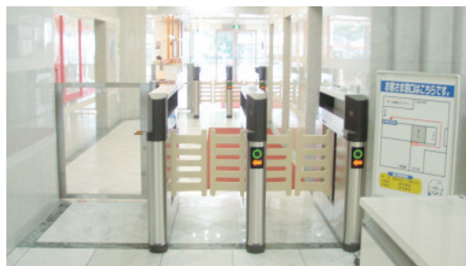
宮崎支社セキュリティゲート
