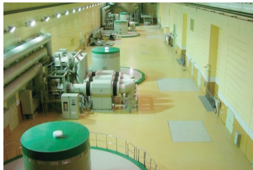
小丸川発電所(地下発電所)
