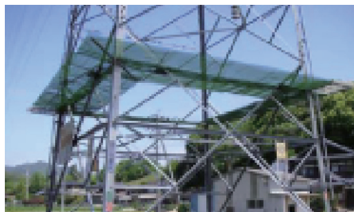
送電鉄塔の昇塔防止装置設置状況
