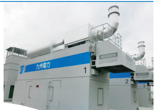
豊前発電所に設置したディーゼル発電機
