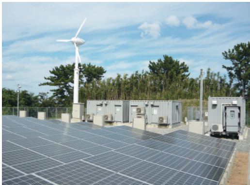
黒島の実証試験設備(鹿児島県)
