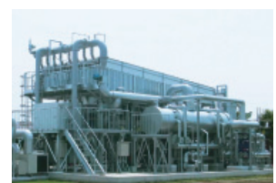
山川バイナリー発電設備
