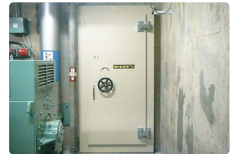
タービン動補助給水ポンプ室の水密扉
