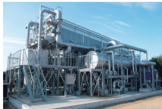
山川バイナリー発電設備
