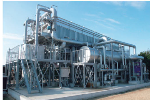
山川バイナリー発電設備
