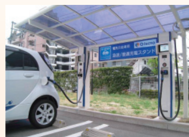
Qテクノ本店西エリア3号館玄関前に設置している急速充電器(スタンド2台タイプ)
