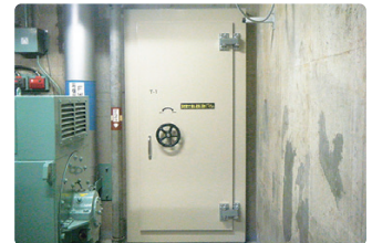
タービン動補給水ポンプ室の水密扉
