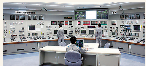
玄海原子力発電所訓練センターシミュレーター室
