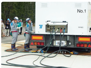
移動式大容量発電機を使った 電源供給訓練
