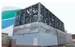
復水タンクの竜巻防護ネット
