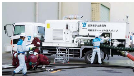
可搬型ディーゼル注入ポンプの設置
