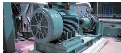
常設電動注入ポンプ
