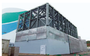
復水タンクの竜巻防護ネット
