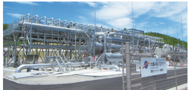
菅原バイナリー発電所
