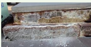
コンクリート構造物の酸性劣化状況【補修前】
