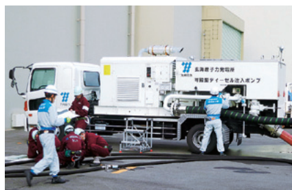
可搬型ディーゼル注入ポンプの設置
