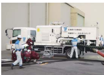
◇可搬型ディーゼル注入ポンプの設置
