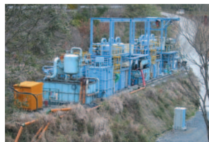
濁水処理設備
