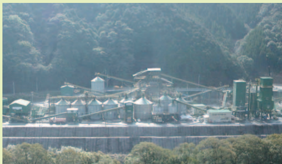
コンクリートの製造が完了し、設備の撤去を行っています。
