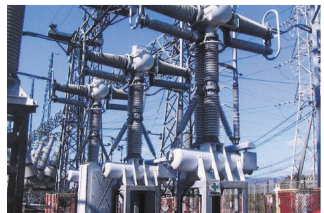
ガス絶縁開閉器
