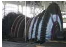
定期点検中の蒸気タービン
