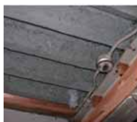
吹付け石綿(建物への吹付け)
