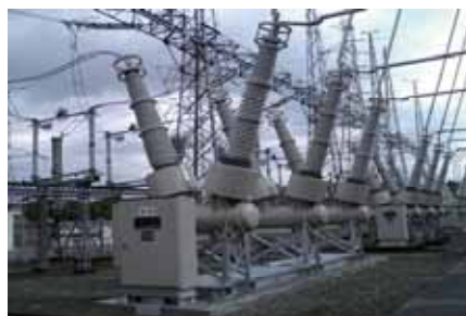
ガス絶縁開閉器
