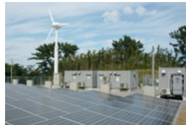
黒島の実証試験設備(鹿児島県)
