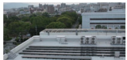
太陽光発電設備
