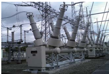
ガス絶縁開閉器
