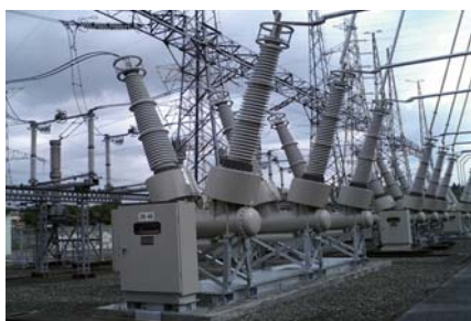
ガス絶縁開閉器
