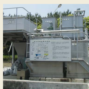
排水処理装置
