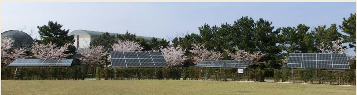
太陽光発電設備設置状況(玄海エネルギーパーク)
