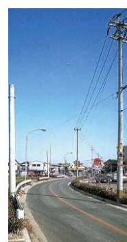
コンクリートポール
