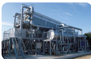
山川発電所の小規模地熱バイナリー発電設備
