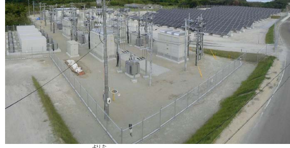
薩摩川内市実証試験場 (寄田中学校跡地) <模擬配電線、電圧調整機器、蓄電池、太陽光パネル 等>
