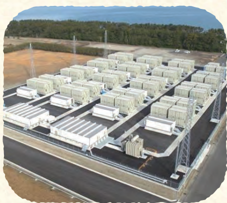
▲豊前蓄電池変電所
