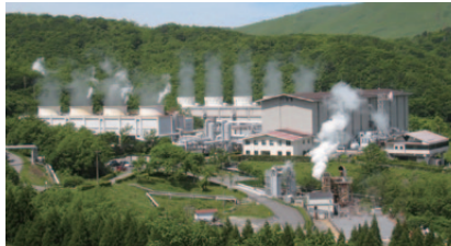
八丁原発電所
