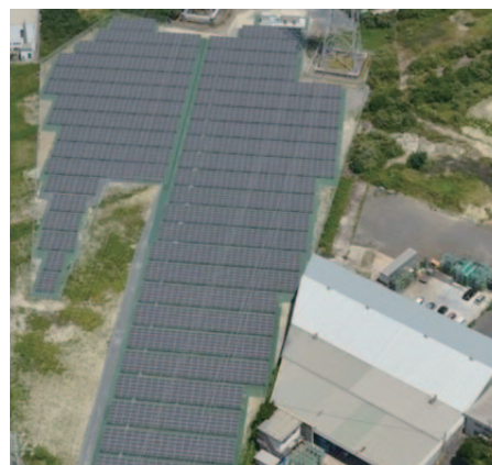
刈田メガソーラー発電所(グループ会社の九電みらいエナジー(株))
