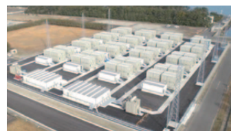
豊前蓄電池変電所 蓄電池設備
