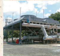
八丁原バイナリー発電施設
