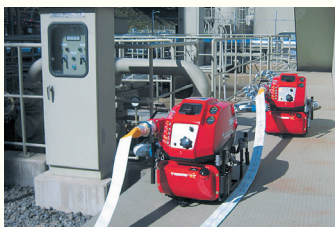
① 仮設ポンプ
