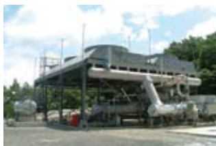
八丁原バイナリー発電所
